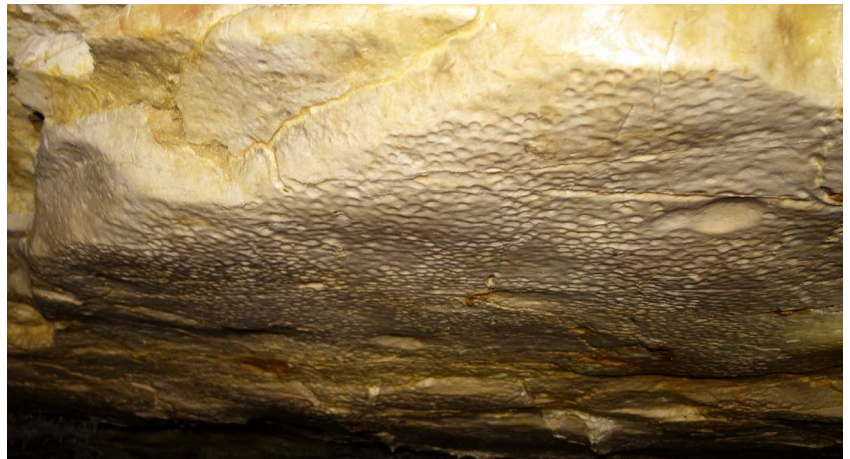
Figure 4. Plafond de la galerie dans la zone d'entrée. Les petites alvéoles attestent d'une corrosion de condensation (CC).
